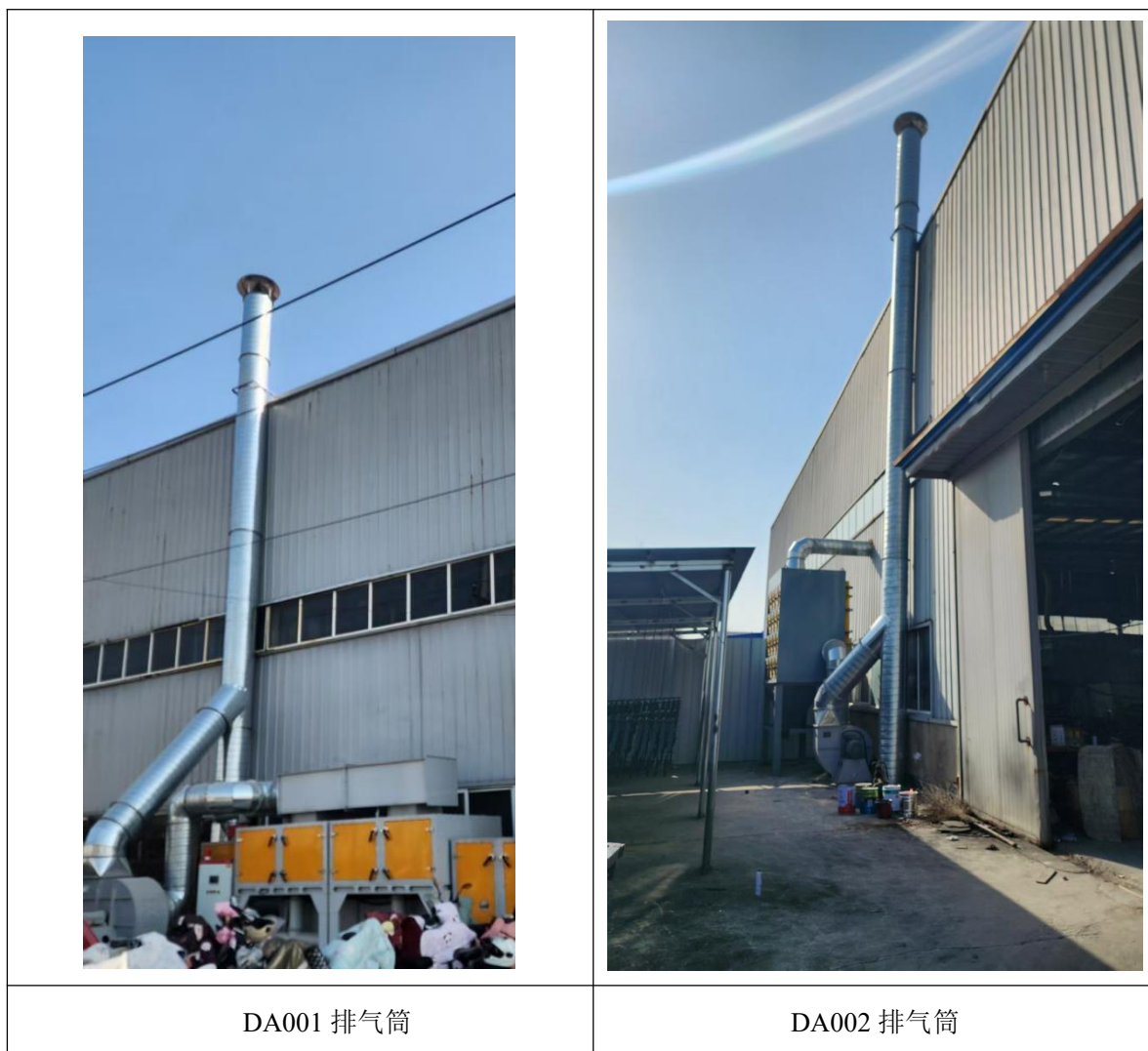
图 4.1-2 排气筒及废气处理设施
