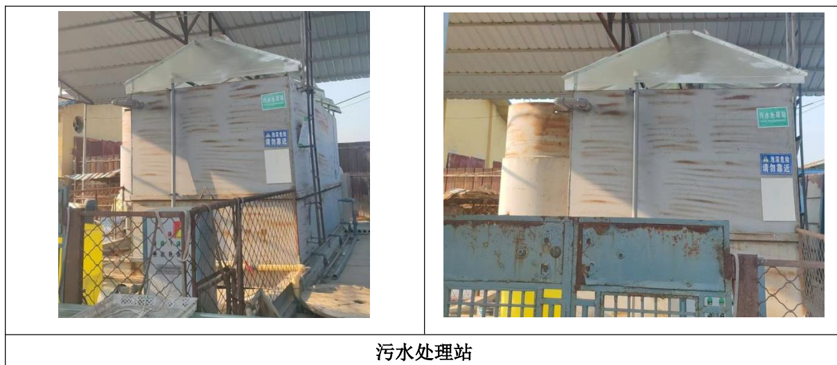
图 4.1-2 污水处理站现场图
