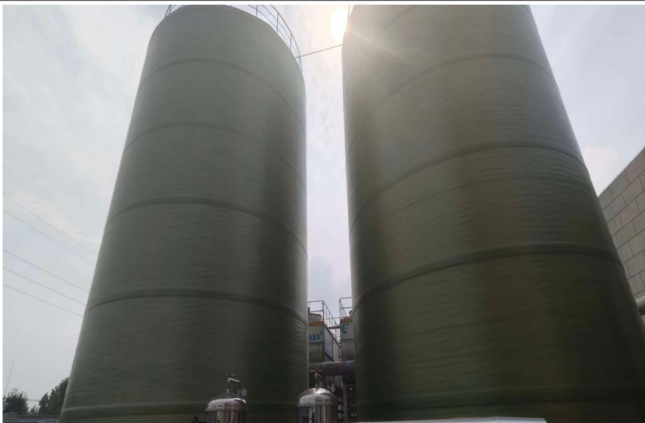
消防水罐，每个 480m 3
