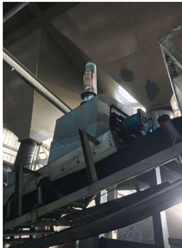
车间废气收集管道
